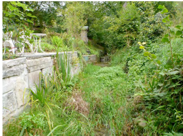
F: Enzenbühlstr: verbaut mit Abstürzen
